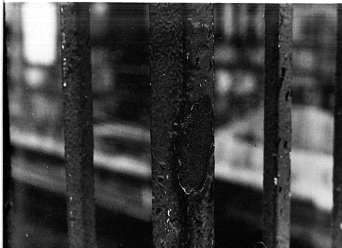
Figur 22. Selv tykke malingslag afsprænges, hvis der ikke er foretaget en grundig afrensning forud for malearbejdet.
