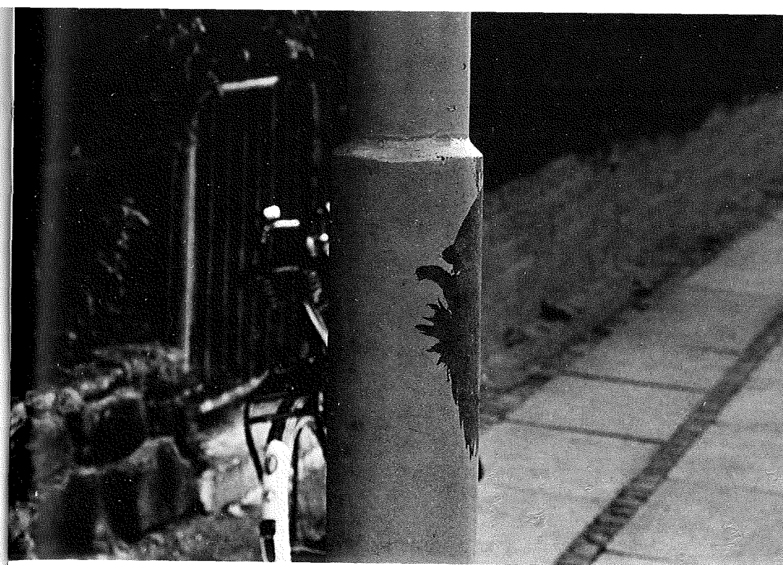
Figur 23. Eksempel på afskalning af maling på varmforzinket stål. De fleste malinger hæfter dårligt på en frisk zinkoverflade. Derfor må disse have en særlig behandling inden malingen påføres.
