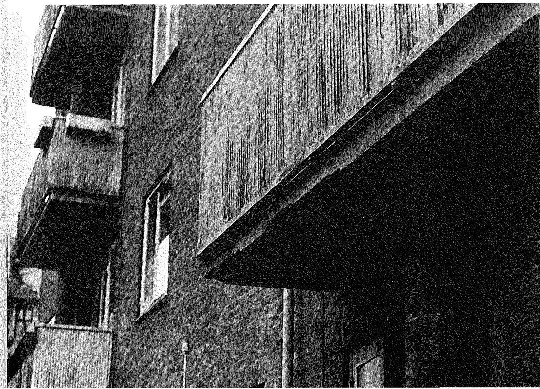
Figur 20. Her er der sket afsprængning af betonen i altanforkanten, fordi dæklaget ikke har været tykt nok.
